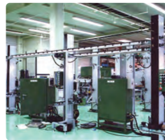
各工程をつなぐ、コンベア、リフター、パッファ装置等
